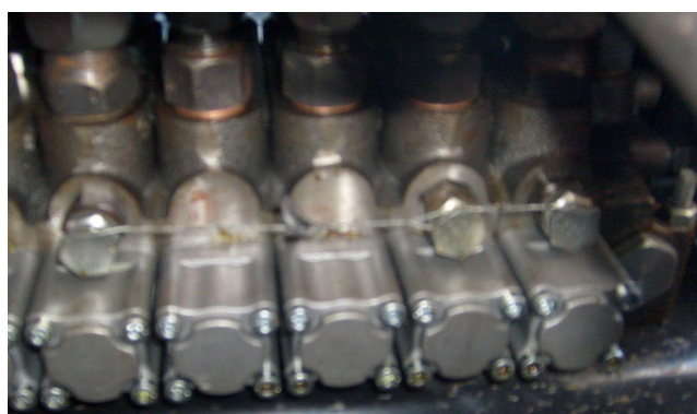
Рис.7 Пломбирование гидрораспределителя (снаружи кабины, вид снизу со стороны экскаваторного оборудования).
